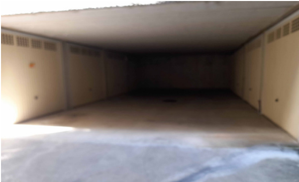
Vista interna unità
