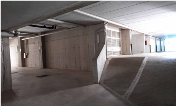
Vista interna unità
